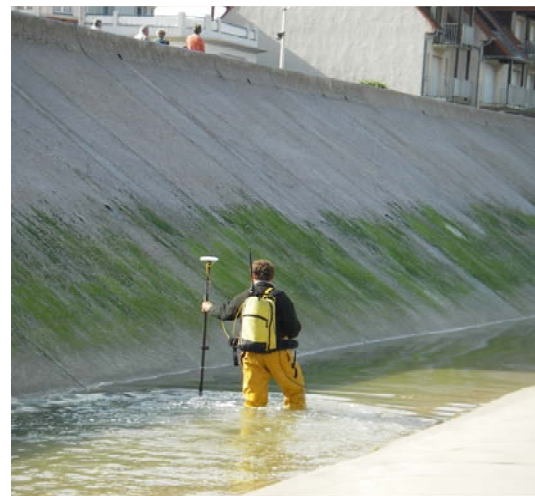
Affouillement pied de perré
