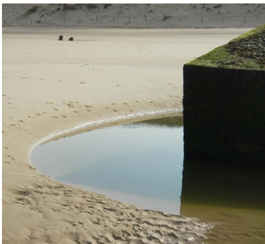
Affouillement pied blockhaus
