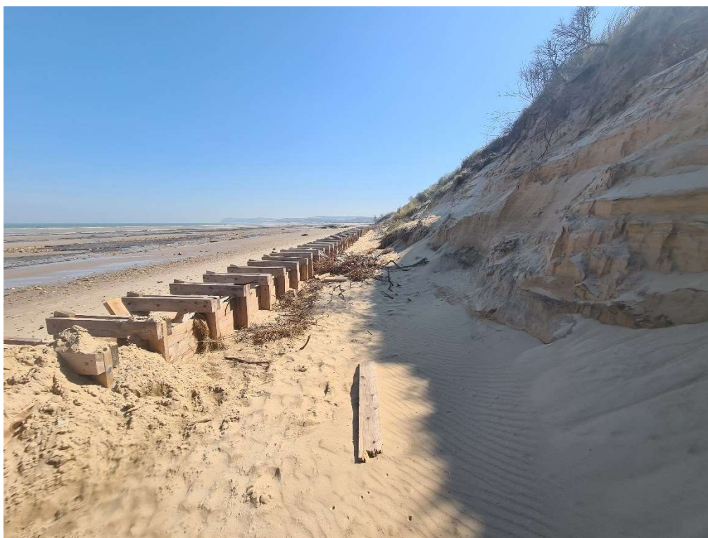
Figure 17 : Recul du trait de côte en arrière des casiers Tardinghais situés au centre du massif de la dune du Châtelet
