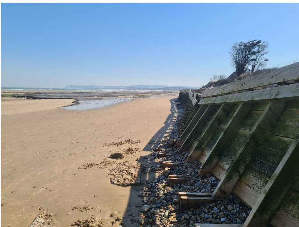
Figure 16 : Situation du haut de plage devant les casier Tardinghais ouest. L'estran est bas et soumis à d'important affouillement lié aux phénomènes de réflexion de la houle. Ces casiers agissent comme une digue et ne favorise pas l'engraissement de la plage
